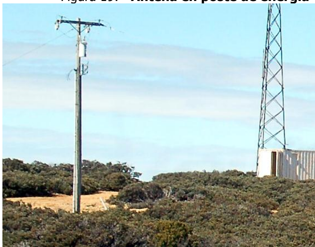
Figura 19: –Antena en poste de energía
